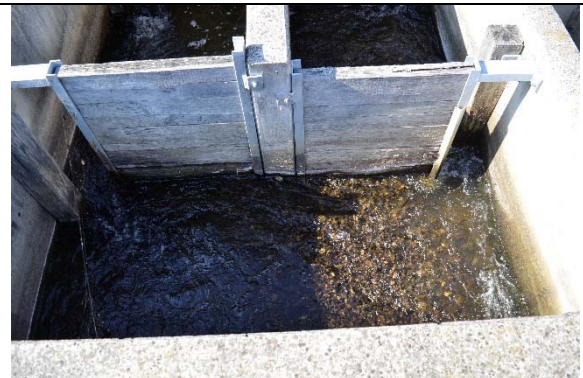
Abbildung 38: Hydraulische Tiefe unzureichend
