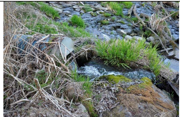
Abbildung 12: Stark verklaustes Rohr für Zusatzdotation (Unterwasser)
