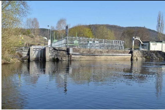
Abbildung 25: Beginn Triebwasserkanal mit Ausstieg FAH (links)
