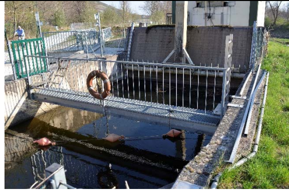
Abbildung 26: Triebwasserkanal mit mechanischem Rechen
