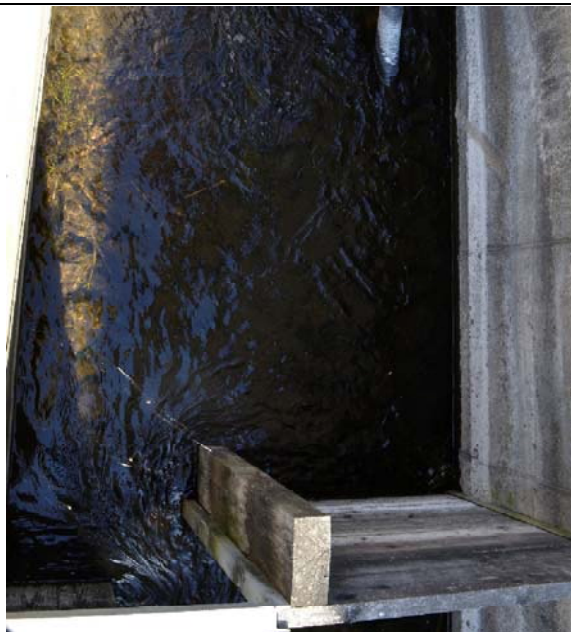
Abbildung 102: Geringe Dotation in FAH aufgrund der Verklausung
