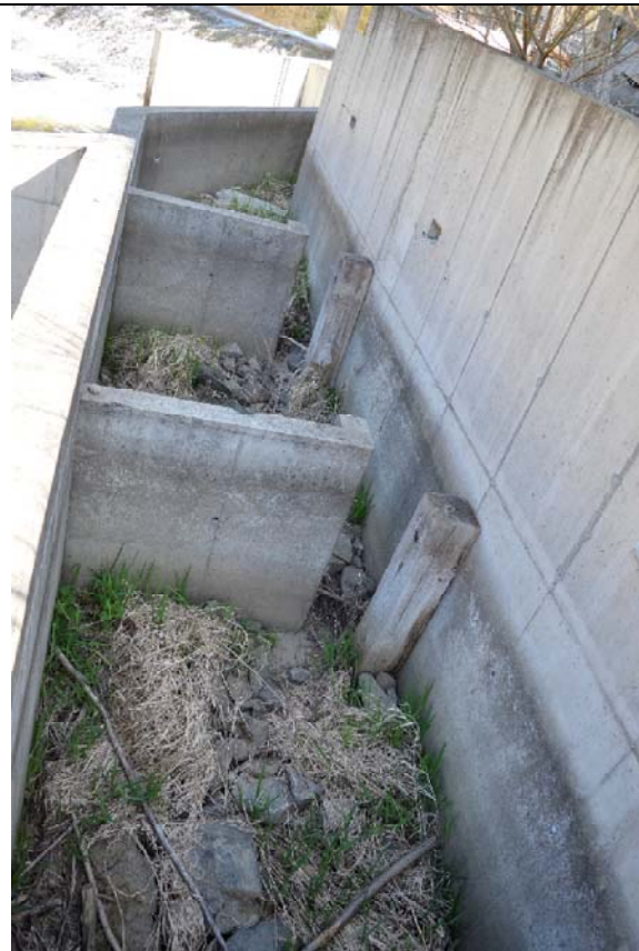
Abbildung 88: Trockengefallener Mittelteil der FAH
