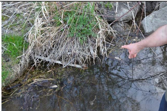
Abbildung 11: Stark verklaustes Rohr für Zusatzdotation (Oberwasser)
