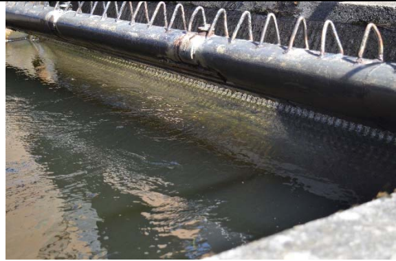
Abbildung 60: Rechen vor Turbineneinlass
