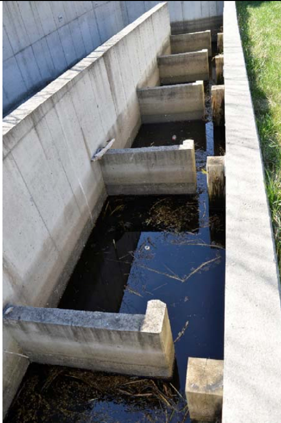
Abbildung 89: Rückgestauter unterer Teil der FAH
